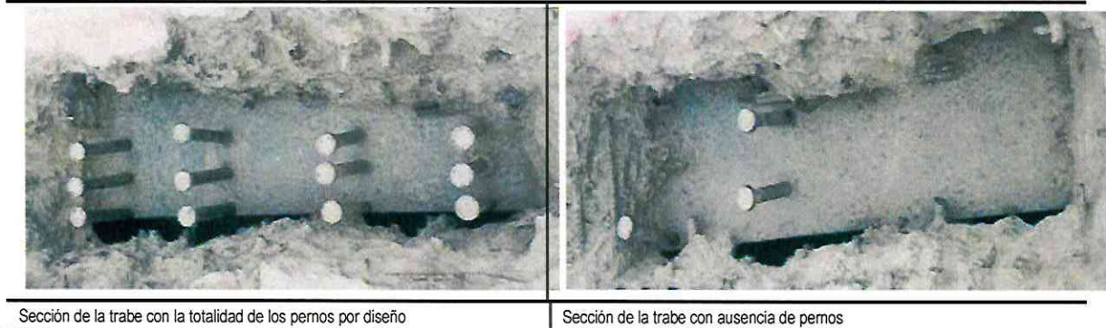
Figura IV.1.11 – Pernos en Sección de Trabe Sur – lado oriente
