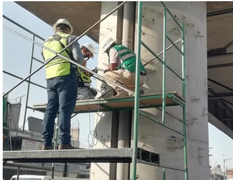
Columna 281. Laboratorio LIAC realizando prueba de ultrasonido en las grietas en el Grout.
