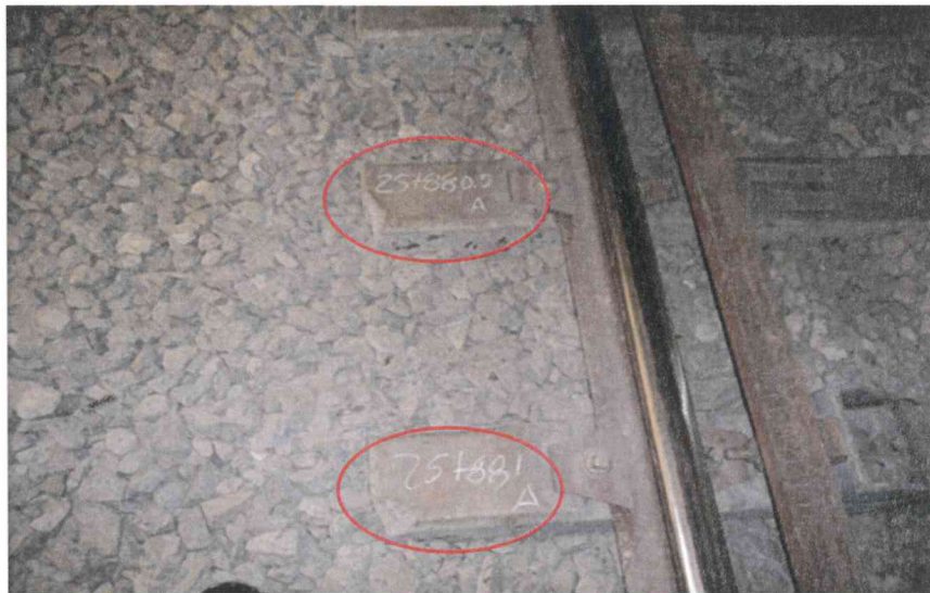
Foto 4. Durmientes fracturados 25+880.5 y 25+881 fila "A"
