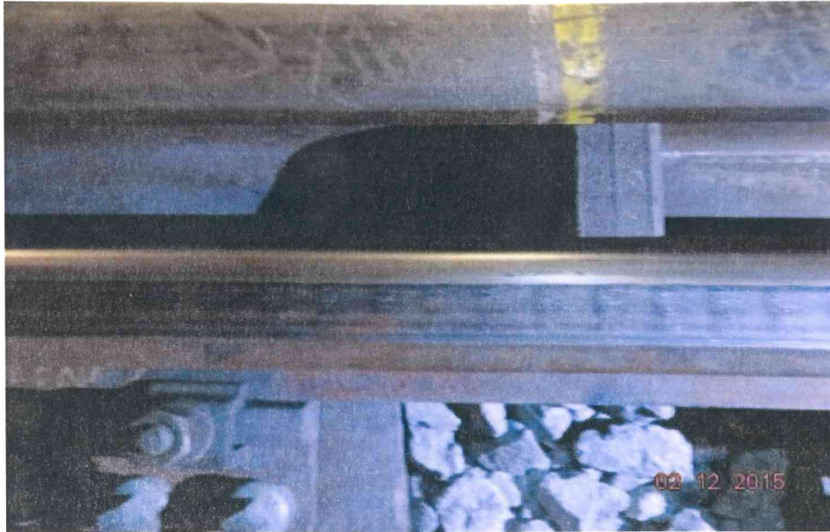
Foto 3. Desgaste ondulatorio de amplitud 5-6 cm - Estación Mixcoac vía 2 PK 28+450
