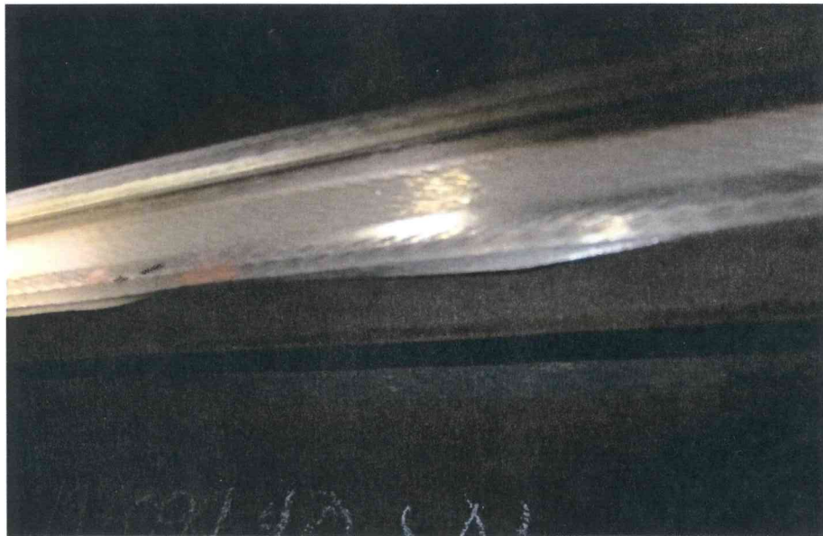
Foto 2. fluencia del hongo – Estación Atlalilco Curva N° 37 –vía 2 – PK 19+185
