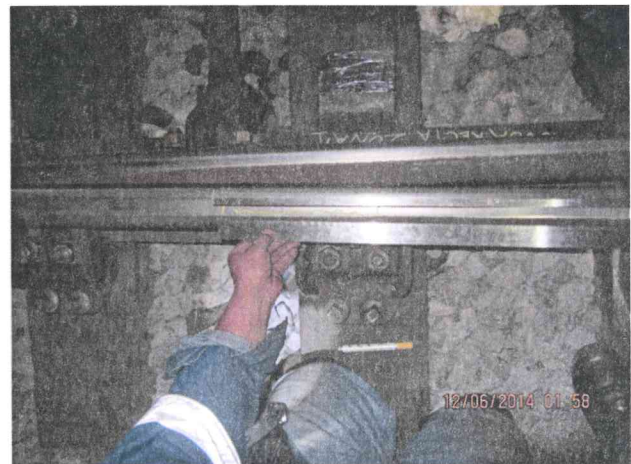
Medición del tramo desgastado en el punto 2 (26 cm longitudinales)
