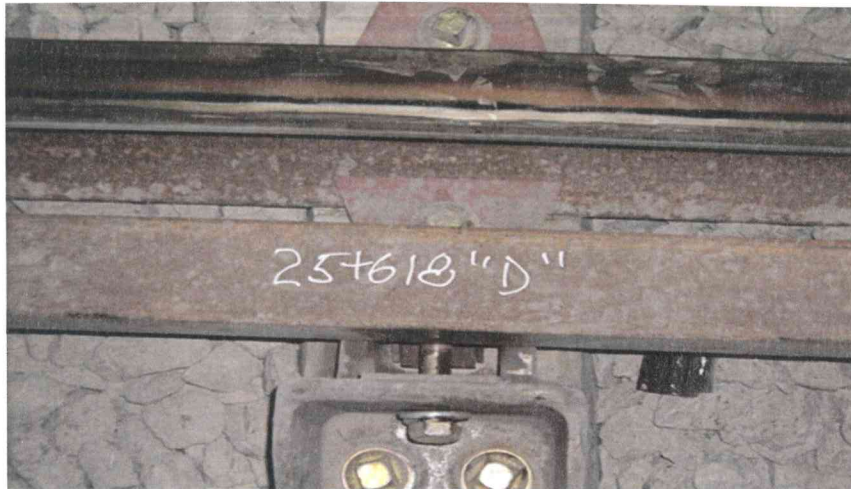
Foto 7. Tornillo de contra riel roto – PK 25+618 Fila D
