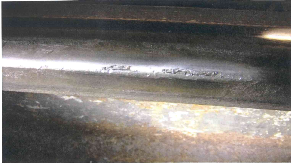
Foto 1. Head-checking vía 2 Pk 19+075, cerca de la Estación Atlalilco.
