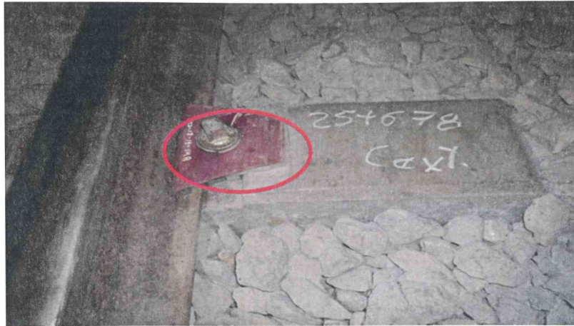
Foto 6. Nabla fisurada, marcada con gis la fisura 25+678 fila "C"
