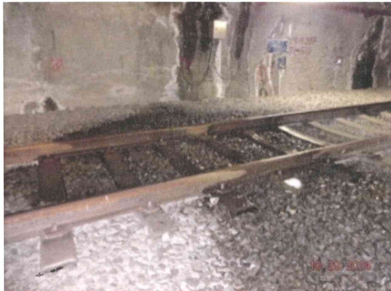
Foto 17. Filtraciones en el PK 27+598
