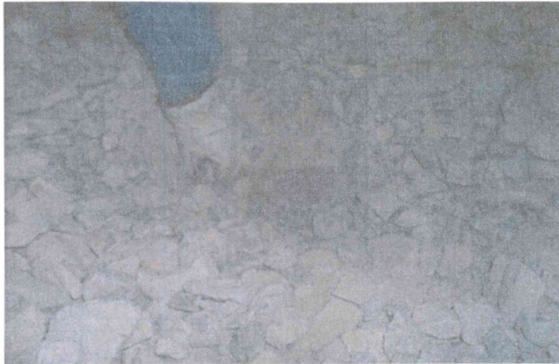
Foto 9. Muchos elementos pequeños PK 23+800
