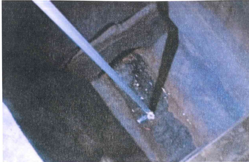
Foto 18. El agua fluye en el sistema de drenaje, se puede observar elementos exteriores (PK27+700)
